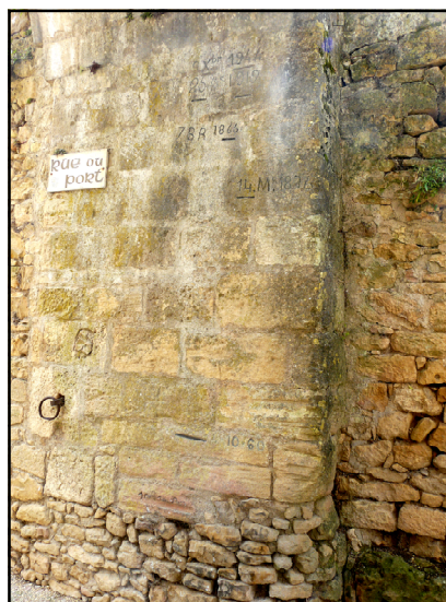
Inscriptions de la hauteur des crues sur le piédroit de la porte du Port.
